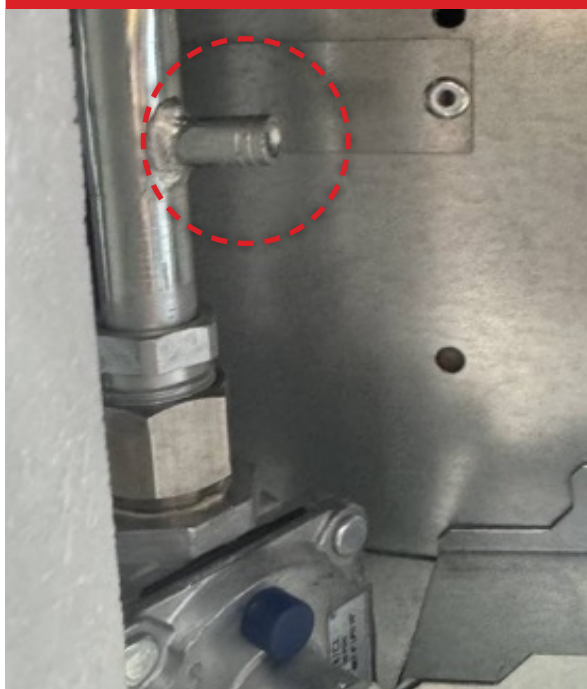
CAPUCHON DE GAZ DU PORT D'ESSAI MANQUANT
